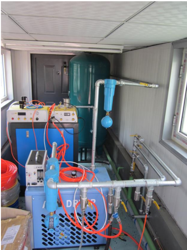
图 4.6 气溶胶发生室内部实物图
